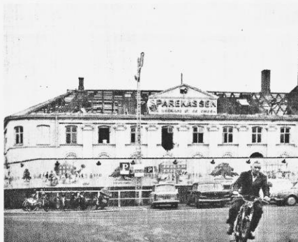
Nedrivningen af Sparekassens bygning er godt i gang, delvist skjult bag flot plankeværk med Brendekilde malerier af sparekassens udvikling.
